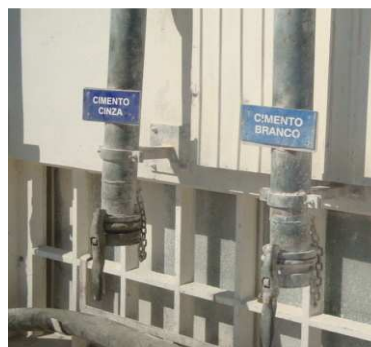
Fig. 4.16 - Tubagens de ligação aos silos de ligantes
