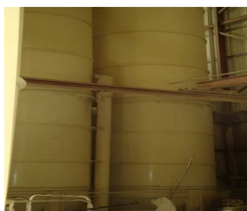
Fig. 4.17 - Silos de Ligantes
